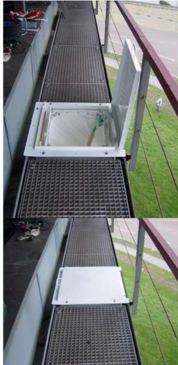
Instalado en diferentes edificios
